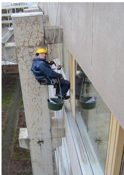
Undersökning av betong med ASR-skada. Ballast från Mälardalen.
