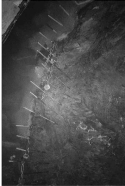
Figur 6. Exempel på fixerade förbultar där en salva sprängs framför bultarnas installerade läge (Holmøy & Aagaard, 2002).
