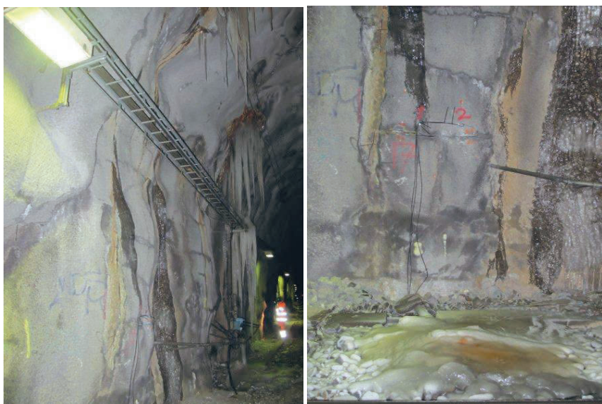
Figur 1. Foto av drän prio 1 vid km 17+696 vänster. Det vänstra fotografiet visar dränen från sidan. På bilden syns de stora istapparna som bildas vintertid på kanterna av dränen och svallis. Det högra fotografiet visar dränen framifrån.
