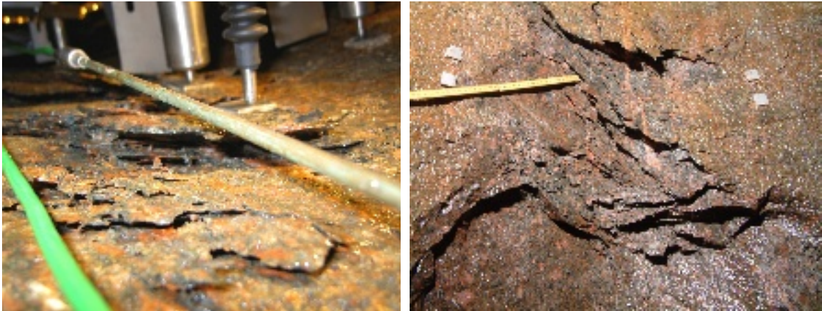
Figur 4. Fotografier av instrumentnivån på 3 m. Vänstra fotografiet visar uppsprickningen på grund av spjälkningen innan de lösa bergbitarna plockats ned. Höger fotografiet är taget i samband men nedplockningen av bitarna. Photographs of the 3m instrument level. Left photograph is the spalling induced fractures before the loose slabs have been removed. Right: during removal of the slabs.
